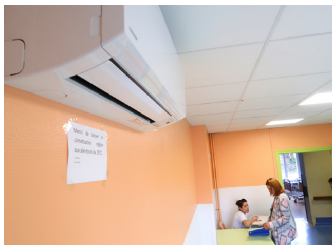
LA SALLE DE VIE DU 1 ER ÉTAGE DU PAVILLON BRACHET, À AIX-LES-BAINS, A ÉTÉ CLIMATISÉE.
